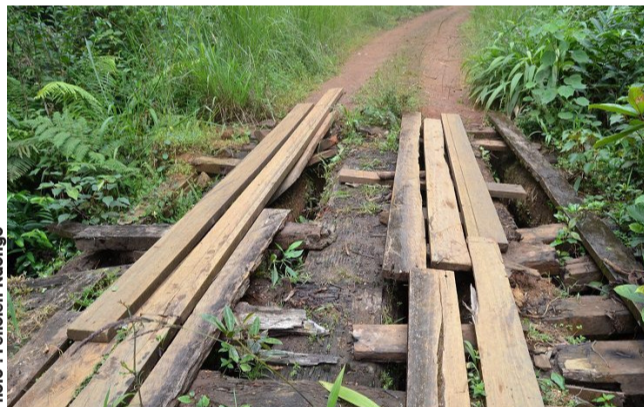
La plupart des ponts sur l'axe Mbigou-Moukabou se trouvent dans un état de dégradation très avancé.
