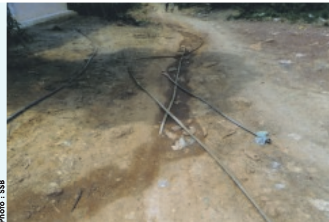
Les fuites d'eau dans un quartier de la ville.
