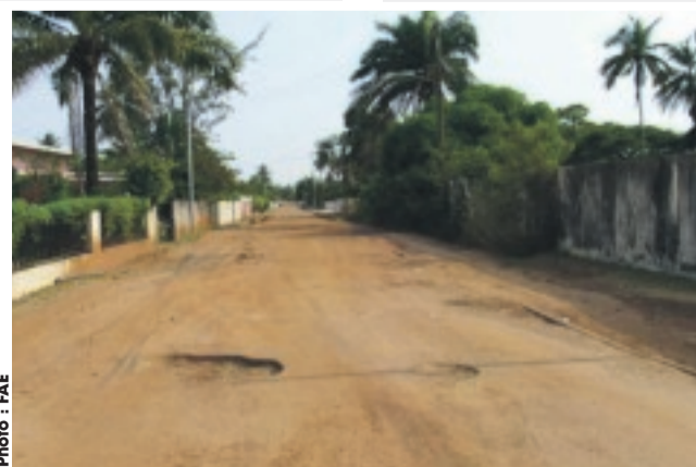
Une voirie à réhabiliter.
