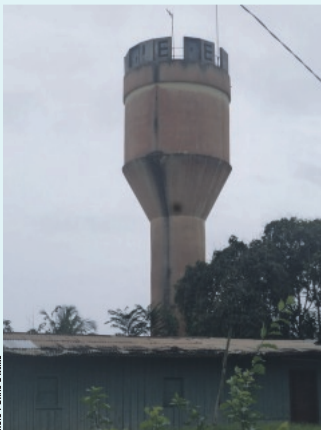
Le château d'eau de Cocobeach abandonné par la SEEG.
