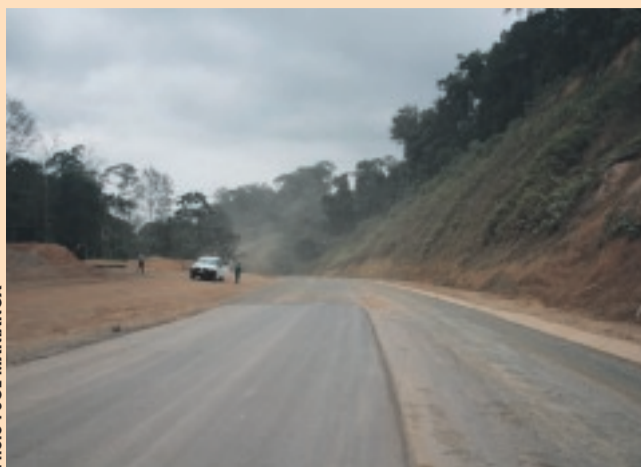
C'est ici, pour l'instant que s'arrête le goudron, à 60 km de Tchibanga. Les travaux se poursuivent.
