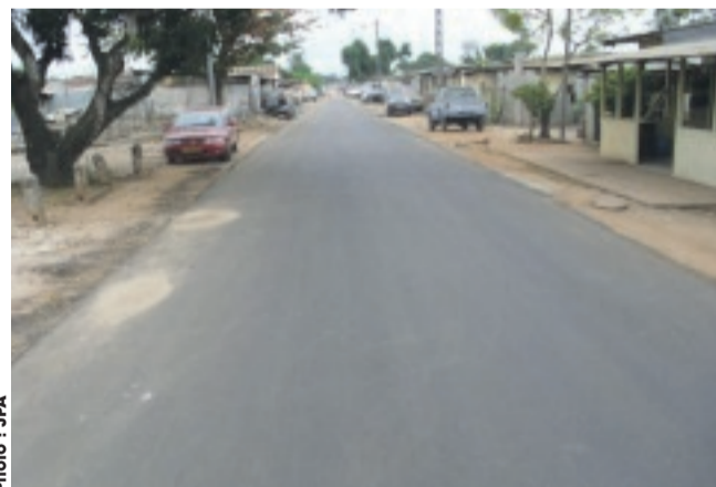
De la fluidité des canalisations dépend la longévité d'une chaussée.
