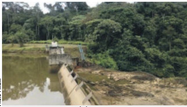
Le barrage de Kinguélé, victime des caprices de la nature. La baisse du niveau de la retenue d'eau est flagrante.
