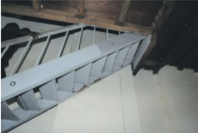
L'escalier menant au clocher, en dégradation avancée.
