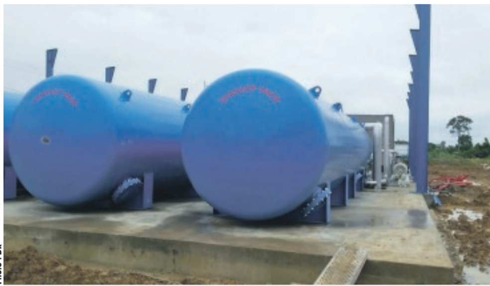
... dans ces cuves pour traitement.
