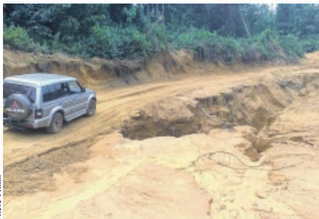
L'état actuel de la voie entre Kougouleu et le village Ayemawoulou : attention danger !
