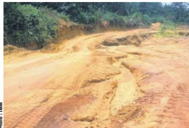
La nature du sol, sablonneux, et l'érosion seraient à l'origine de cette dégradation continue de la chaussée.
