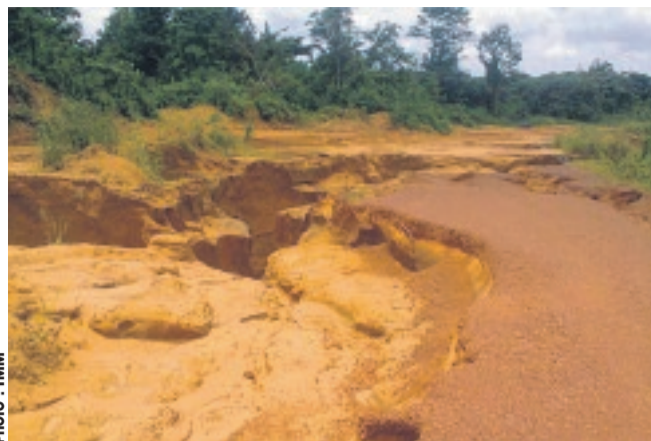
L'ancienne route, après sa déviation à la suite du cratère qui s'y est formé.
