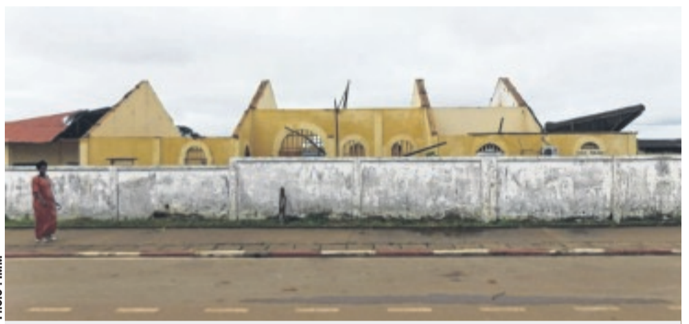
L'école publique a perdu sa toiture.
