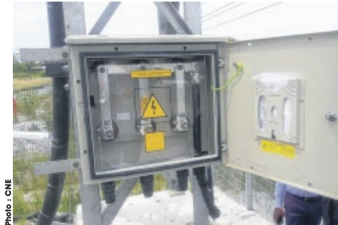
Ce poste électrique a également été détruit.
