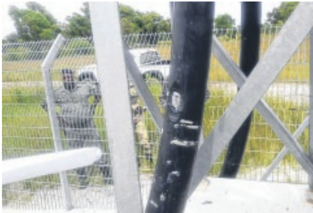
Le pylône reliant la centrale thermique à la SEEG a été saboté par des vandales.
