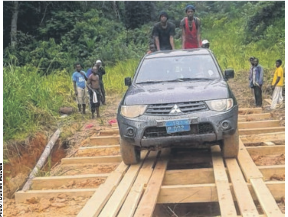
... afin de rétablir le trafic rompu sur Iboundji.
