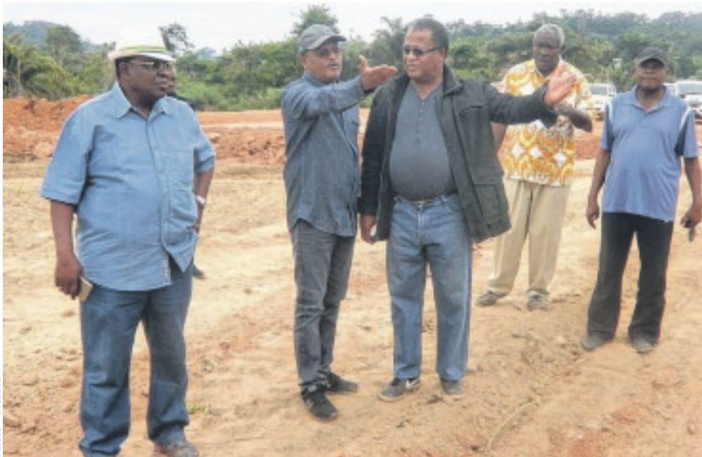
Le président de l'Assemblée nationale, Richard-Auguste Onouvié, visitant un chantier accompagné du maire de Lambaréné.
