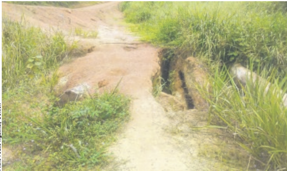
Voilà à quoi ressemblait un des ponts situés dans la zone d'Akam-Effack.
