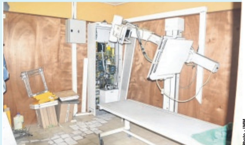
Photo : IMM L'appareillage en panne du service de radiologie
