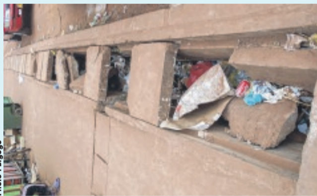
L'état des caniveaux de Lébamba.
