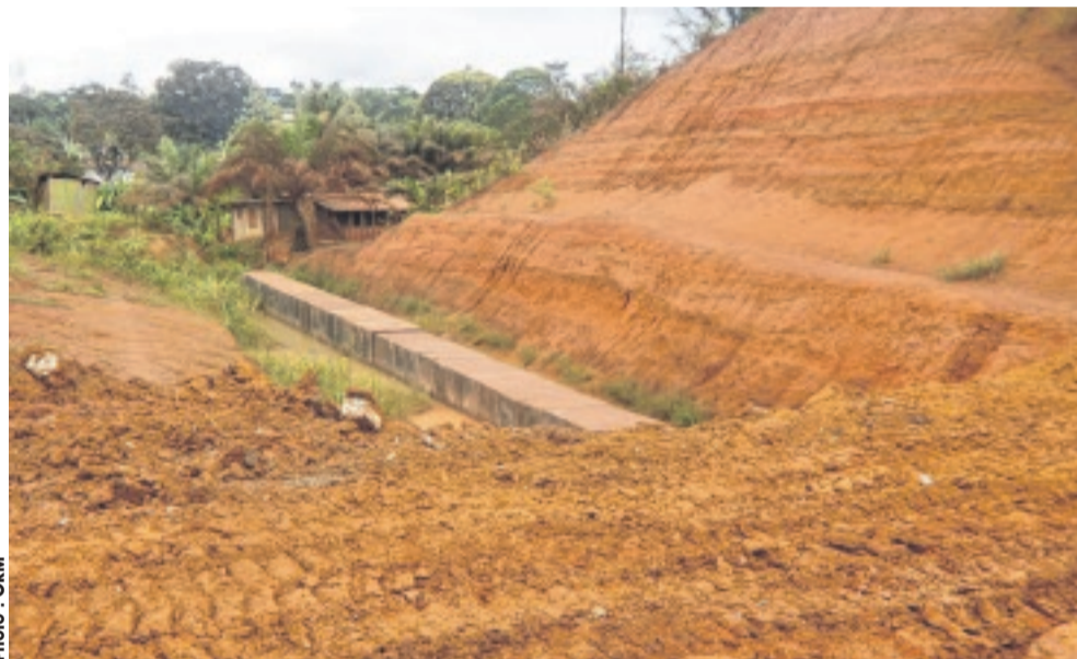
Le problème de cet ouvrage hydraulique de petit diamètre reste entier.
