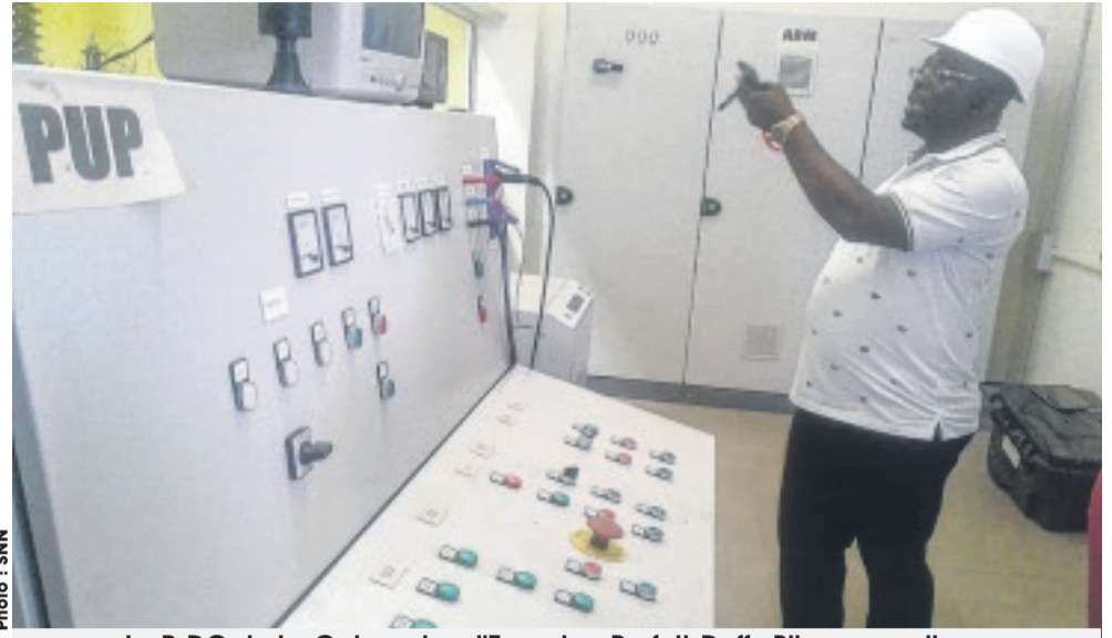
Le P-DG de La Gabonaise d'Énergies, Parfait-Duffy Bibang, explique à ses hôtes le fonctionnement de la salle des essais...
