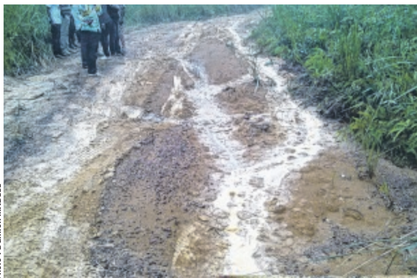
La voie est en permanence altérée par les eaux.
