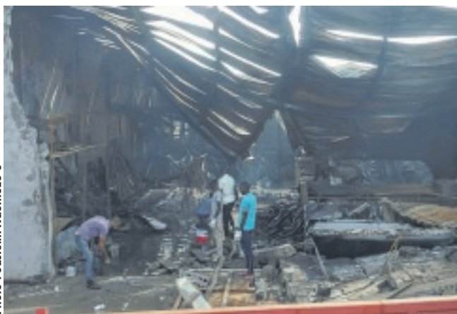
Les dégâts sont considérables.
