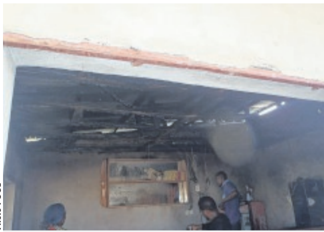
La toiture n'a pas échappé à la violence du feu.
