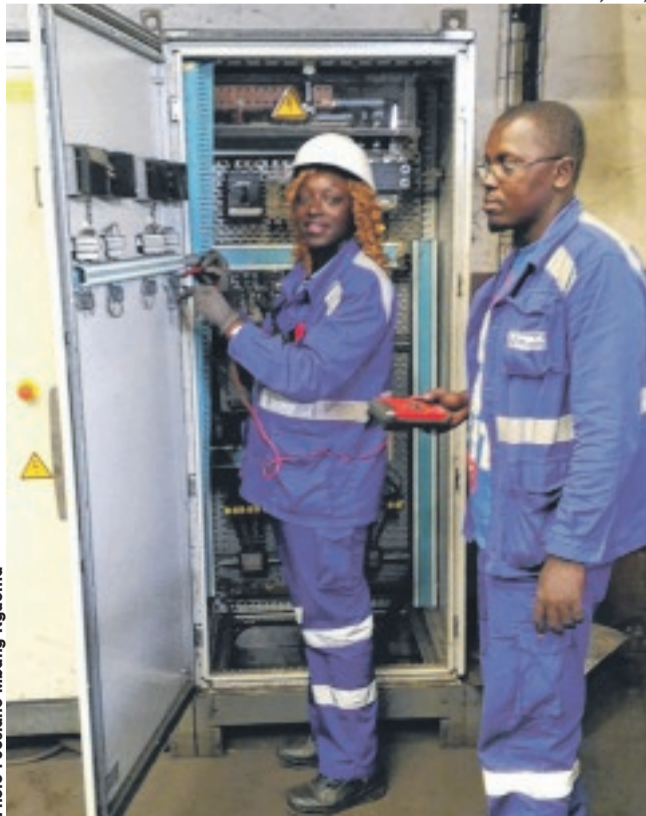
Le service de maintenance des équipements électriques est assuré par l'ingénieur électrique.
