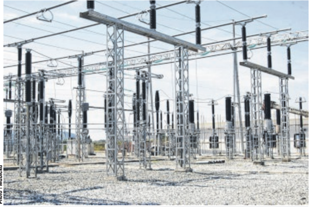
C'est ce professionnel qui conçoit et développe les réseaux électriques.
