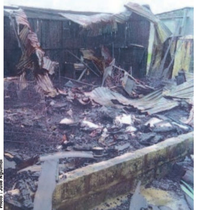
Vue de ce qui reste de la maison sinistrée.
