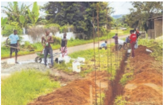
Photo : MOUBEDI BIGOGO Les jeunes pendant les travaux de construction de la barrière.
