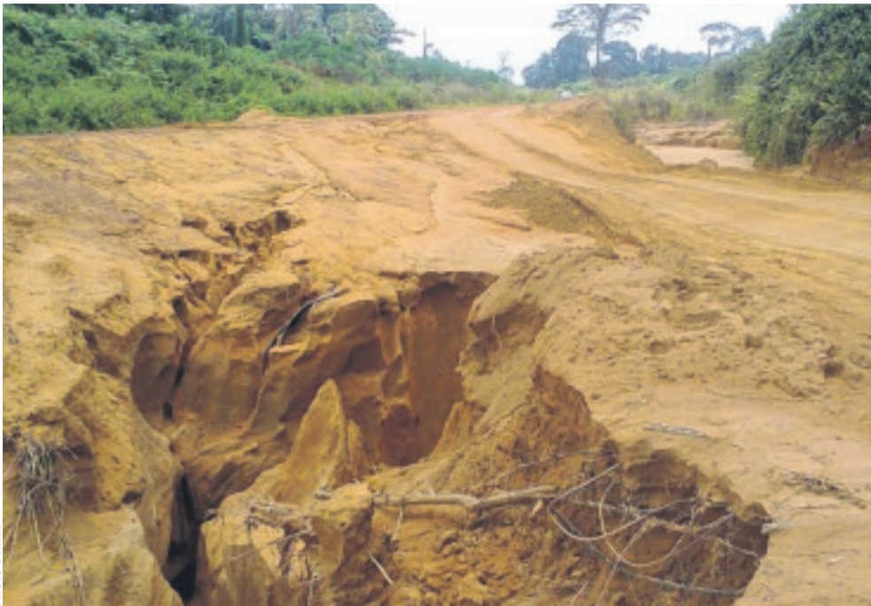
Les dernières pluies ont laissé de gros cratères, tel celui-ci, sur la route.
