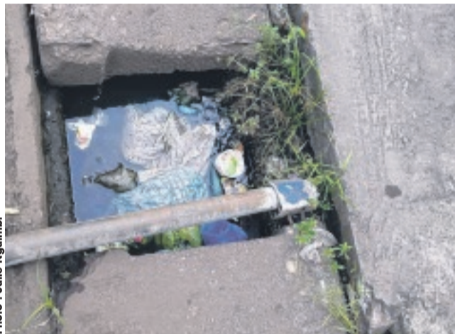
un caniveau transformé en poubelle par incivisme.
