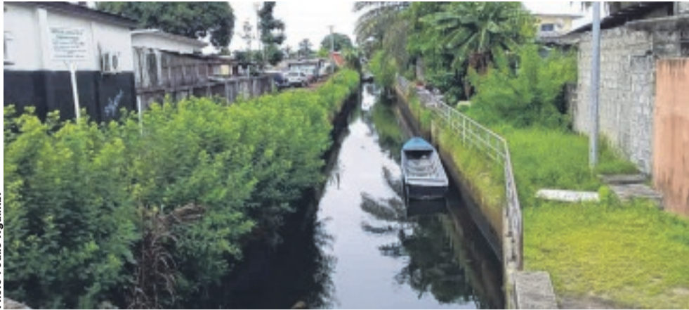
Un canal nettoyé, mais qui nécessite des garde-fous
