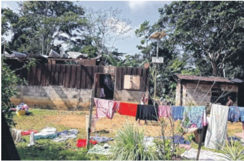
Une des habitations dont la toiture a été emportée.
