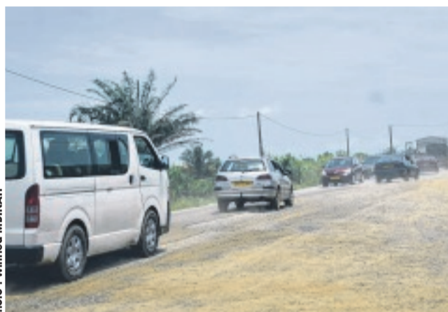
Tout comme sur la route du Cap Estérias, qui se dégrade jour après jour.
