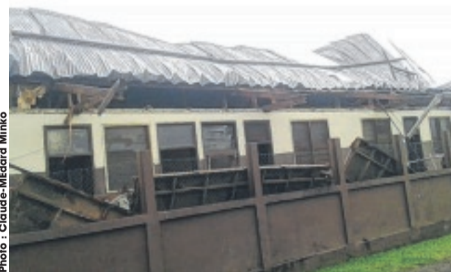
Après avoir perdu sa toiture il y a quelques semaines, à la suite d'un orage, ...
