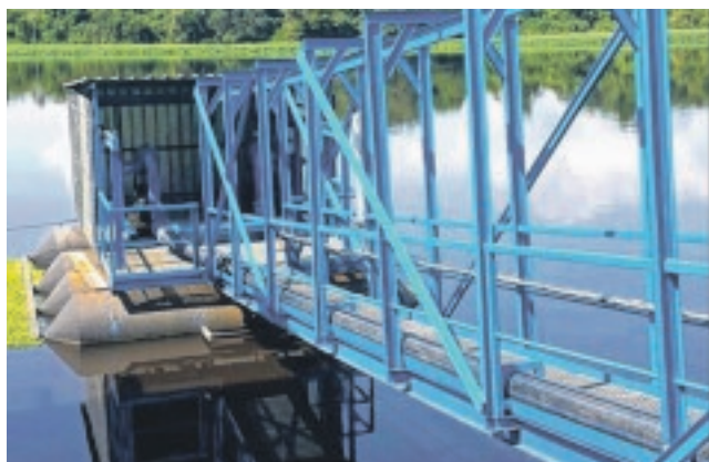
Le nouveau poste de pompage d'eau brute, un ponton flottant doté de deux pompes de 100 m 3 , est déjà opérationnel.
