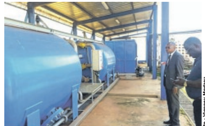
La nouvelle station de traitement d'une capacité de 50m 3 /h sera mise en service dans les prochaines semaines.
