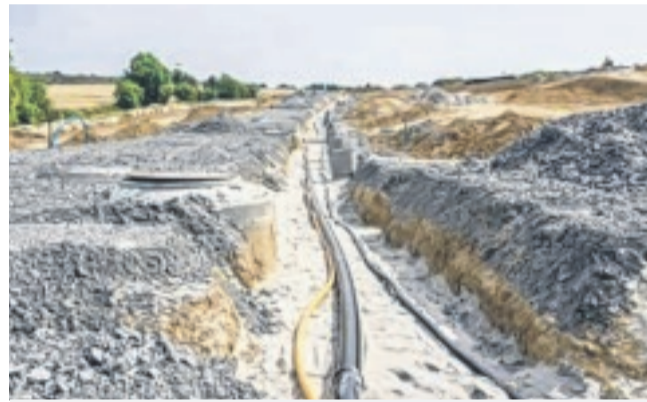
... relier la sous-région via la fibre optique.
