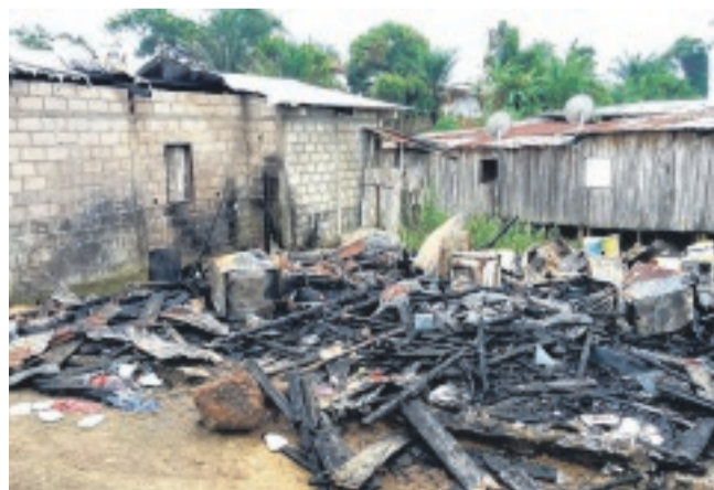
Ce qui reste après le passage des flammes.
