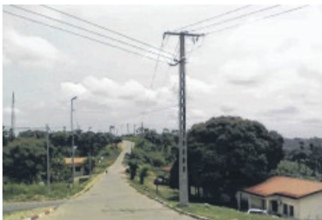
Les installations de haute tension à l'origine de la mort des trois agents d'entretien du réseau.
