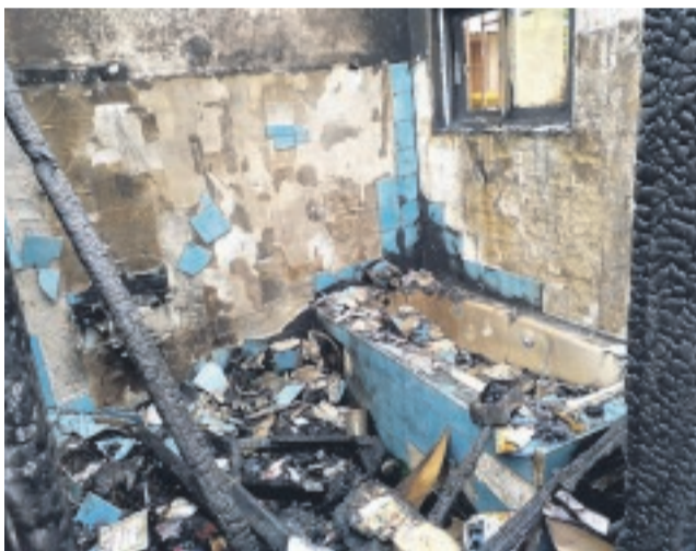
La salle de bain entièrement endommagée.
