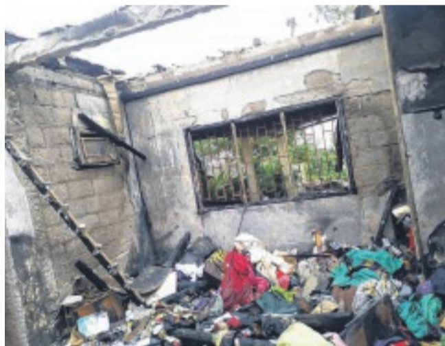
Tout a été brûlé dans cette pièce.
