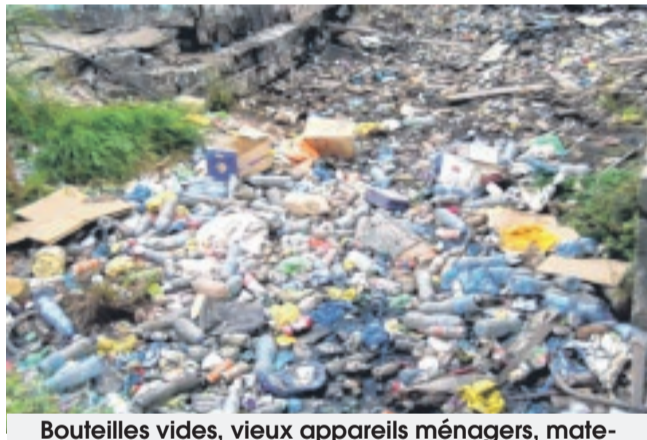
Bouteilles vides, vieux appareils ménagers, matelas et autres déchets sont jetés dans ces ouvrages conçus pour faciliter le drainage des eaux pluviales.
