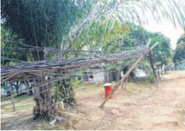
Des câbles de courant installés dans le désordre, exposant les habitants de Montalier-Terminus à d'énormes risques d'électrocution.
