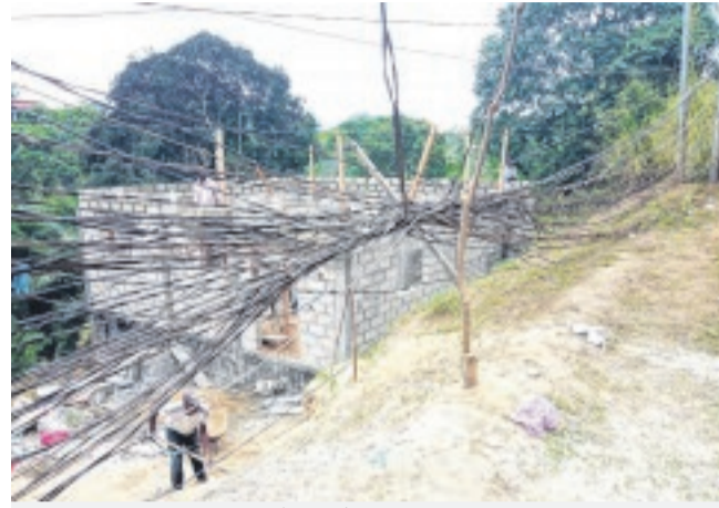
Même pour accéder à ce chantier, les ouvriers courent le risque de se faire prendre par une masse de courant électrique.
