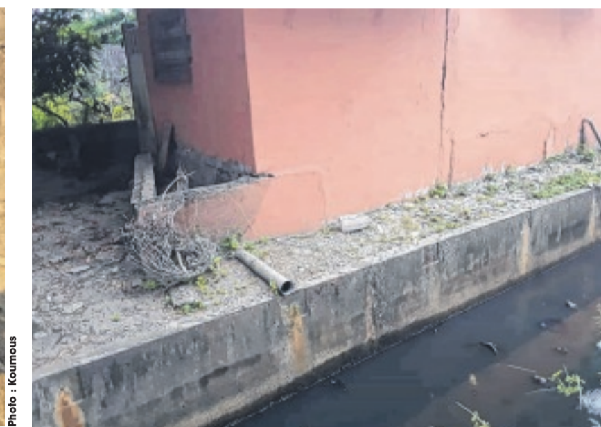
Les PVC d'évacuation des eaux usées donne directement dans le canal.
