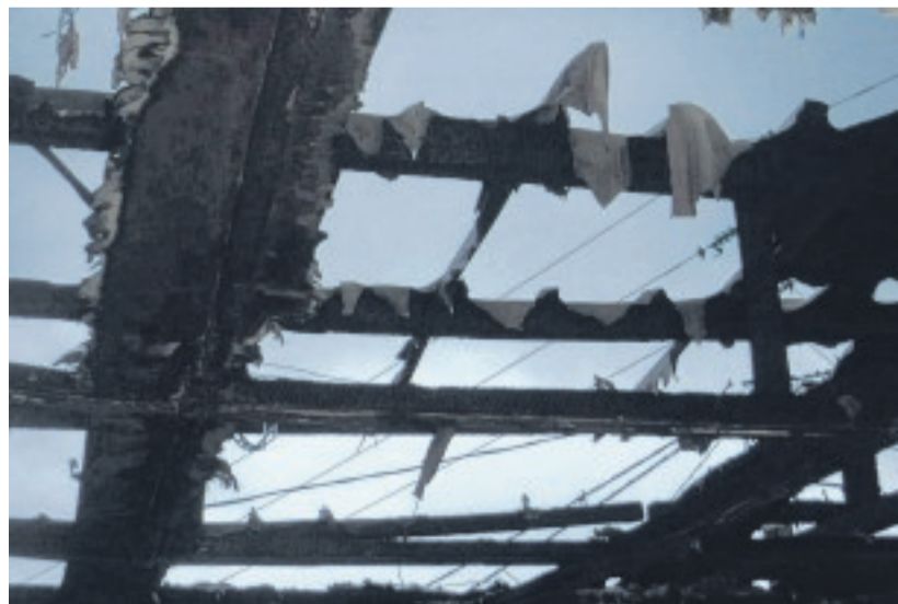
La toiture du magasin après le passage des flammes.
