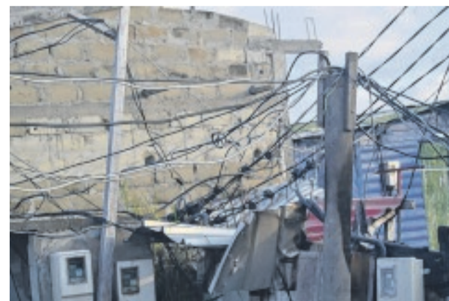
Les branchements électriques anarchiques, cause de l'incendie.
