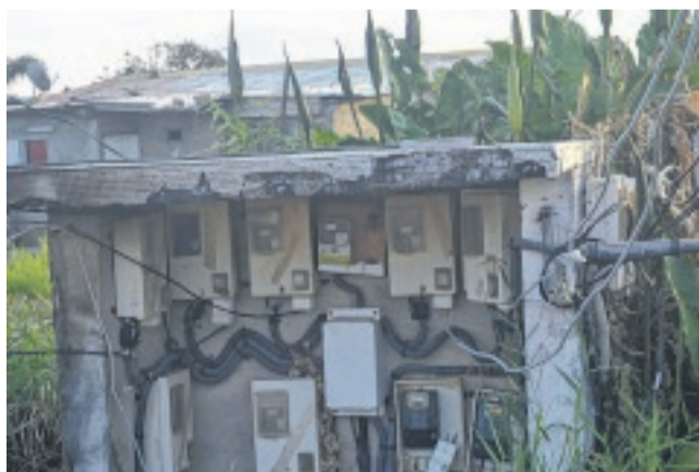
L'état des compteurs après le passage du feu.
