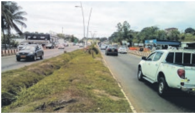
La deuxième partie du chantier des Charbonnages livrée, la circulation se déroule à nouveau sans encombre.
