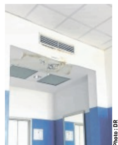
Photo : DR État de la climatisation du CHU d'Owendo.
