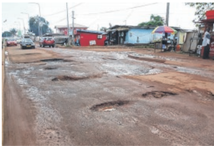
Les voiries d'Oyem, visiblement dégradées. Photo: Gérard Minko
