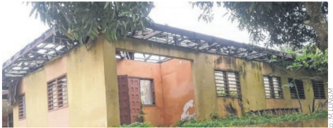
Le bâtiment abritant naguère les services des Affaires sociales n'est plus que ruine.
