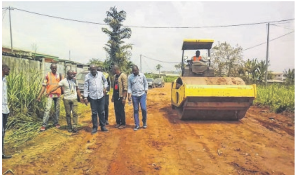
Le maire d'Oyem, Abessolo Menguey, en train de visiter les voiries en travaux.
