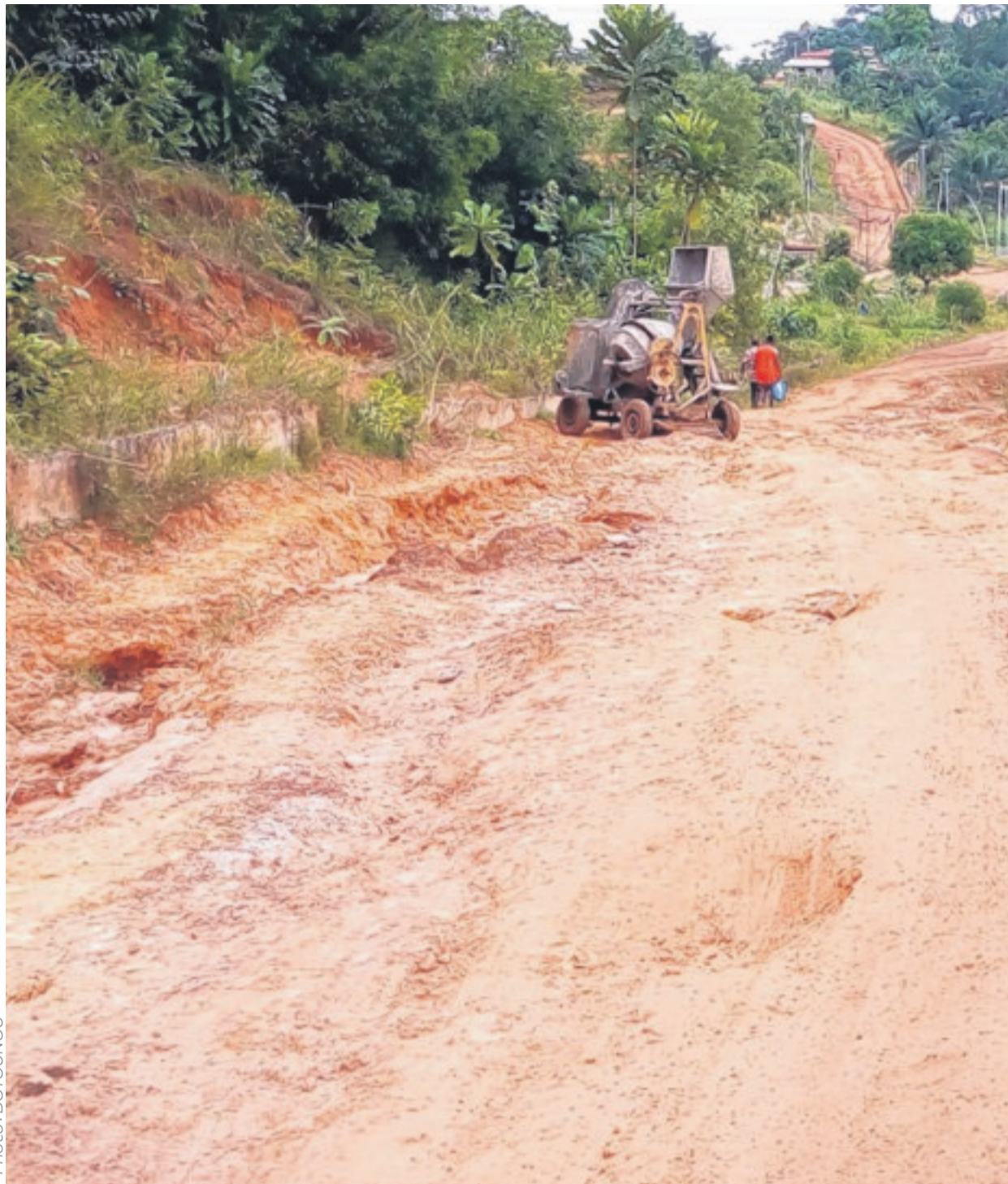
La voie conduisant à Igoumié, fortement dégradée depuis l'arrêt des travaux.
