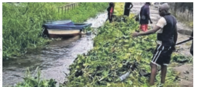
Des riverains ont nettoyé le canal obstrué par la montée des eaux.
