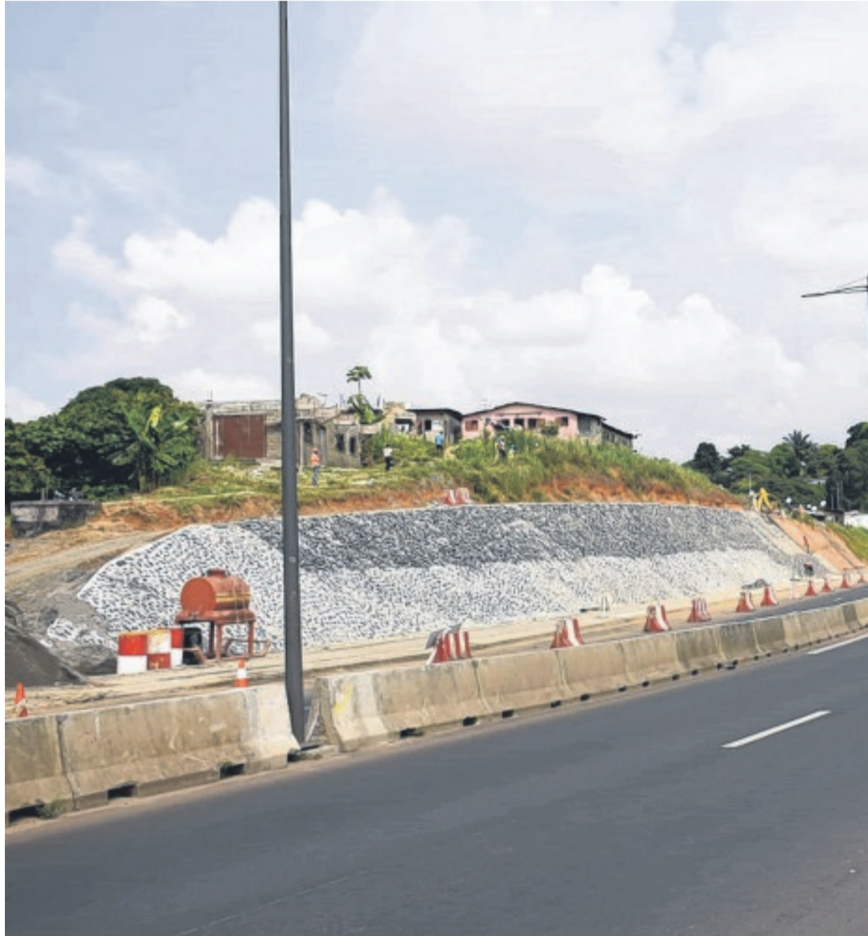
Comme ici, au PK6, les barrières ayant été levées, la circulation est redevenue fluide à Libreville.
