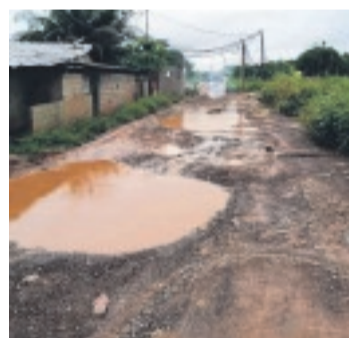
Un aspect de l'état de la route de Bizango-Rails. Bonjour les dégâts !
