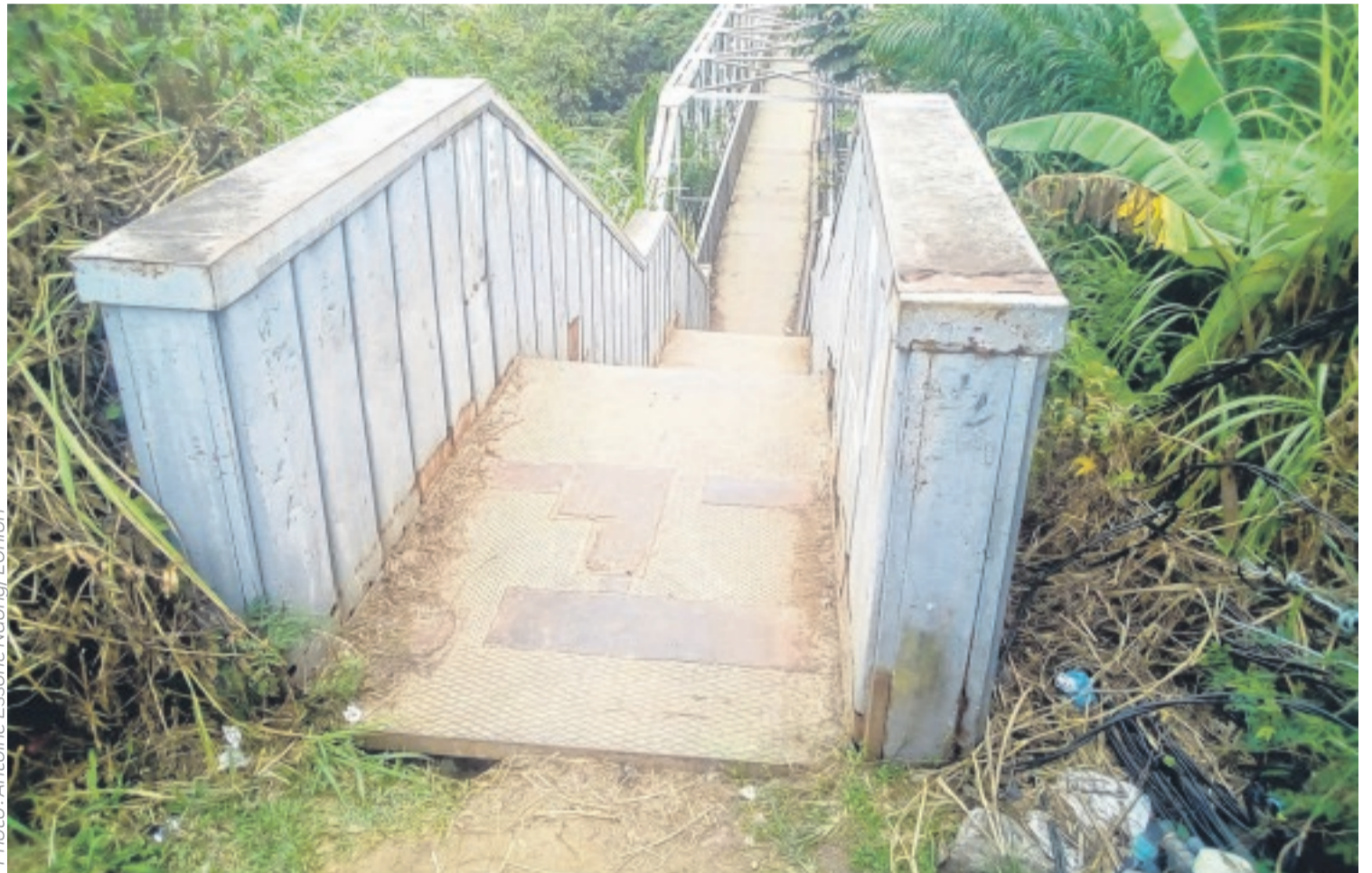
L'ouvrage, aujourd'hui en piteux état, constitue un important lien pour les deux quartiers, Pont-en-Haut et Alenakiri.
